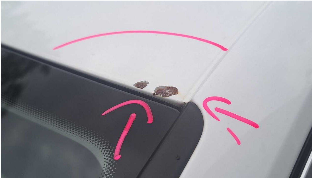
Bild 31 Dach Dachhaut korrodiert
